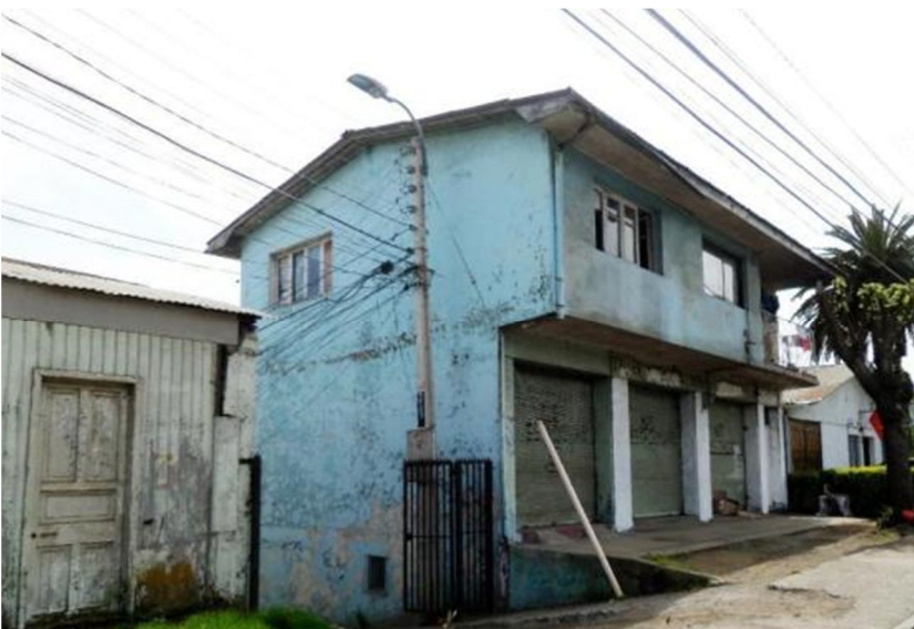
Construcción de dos pisos (comercial el primero y habitacional el segundo) en Avda. Centenario, acera nor-poniente.
