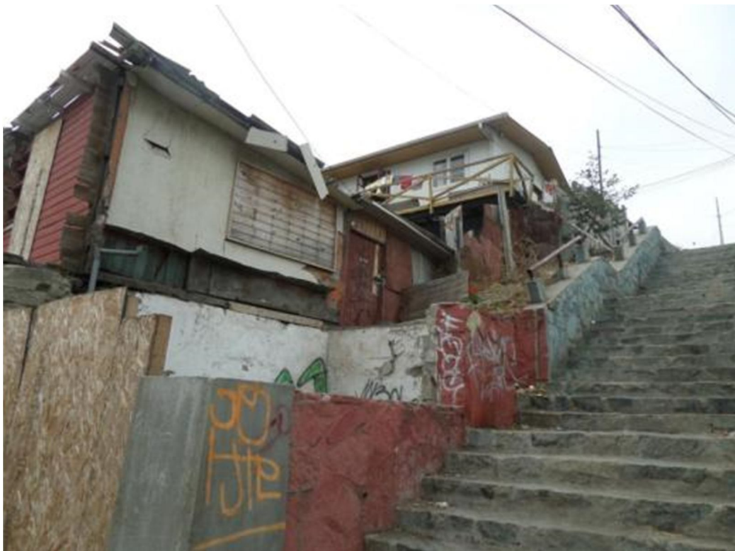
Pasaje peatonal en el borde sur del centro. Escaleras intransitables para discapacitados y ancianos y construcciones que amenazan ruina.
